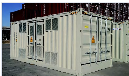
Generator / Transformer Container Contentor gerador / transformador
